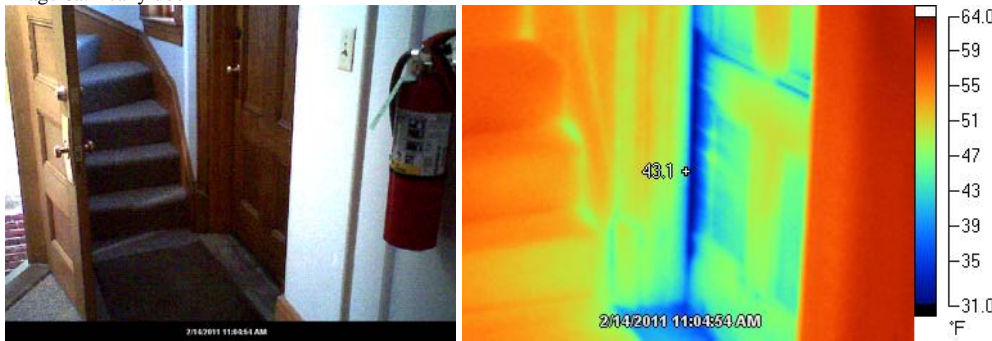
Image 6a: Leaky door
